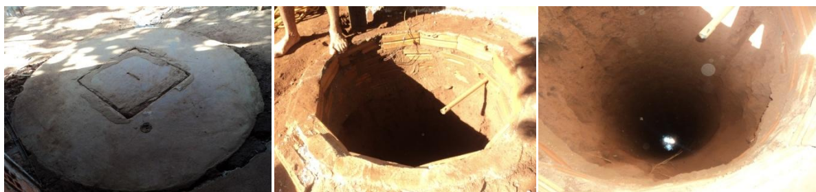
Figura 5 – Imagens do poço artesanal raso do Bairro A, na cidade de Itumbiara-GO.
