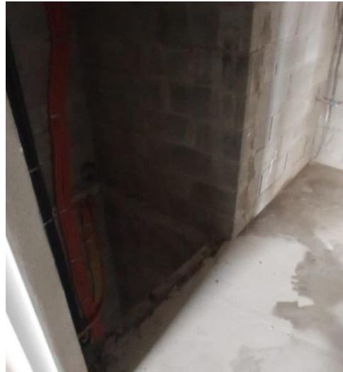
Figura 31: Vão onde há risco de queda sem proteção ou sinalização.
