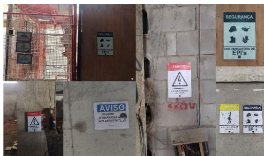
Figura 21: Placas de sinalização
