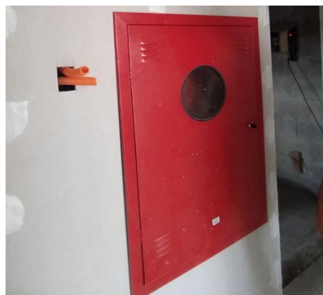
Figura 33: Extintor de incêndio do andar
