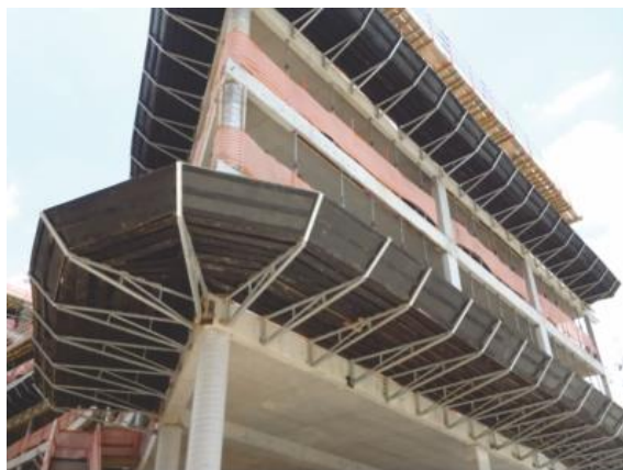
Figura 10: Guarda corpo e plataforma de proteção
