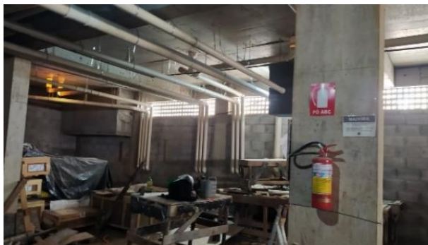
Figura 20: Armazenamento de materiais e extintor de incêndio.
