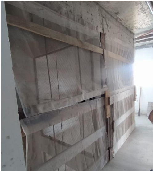
Figura 30: Vão do elevador devidamente isolado.
