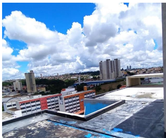
Figura 27: Terraço sem guarda-corpo
