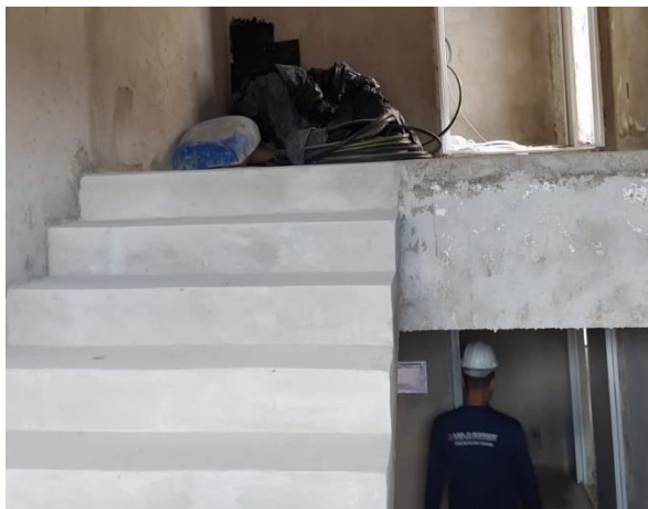
Figura 24: Escadas sem corrimão provisório
