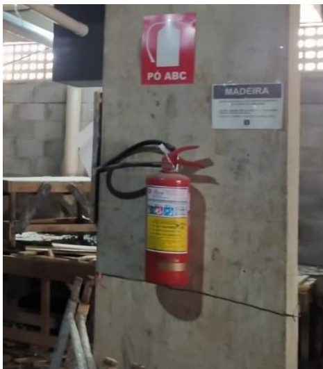
Figura 32: Extintor de incêndio
