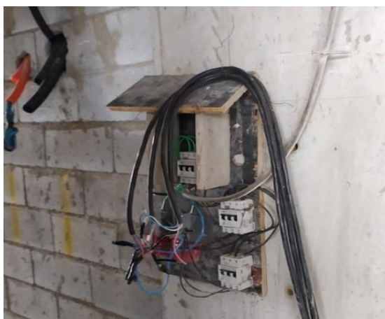
Figura 28: Fios elétricos sem proteção
