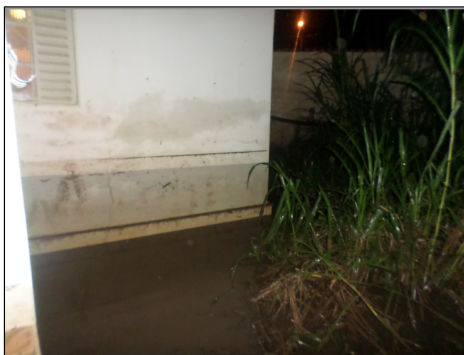
Figura 8 – Inundação residencial na Rua Niterói, Setor Jardim Paraíso, em frente à chácara para eventos Spazio Vital Eventos - 2019
