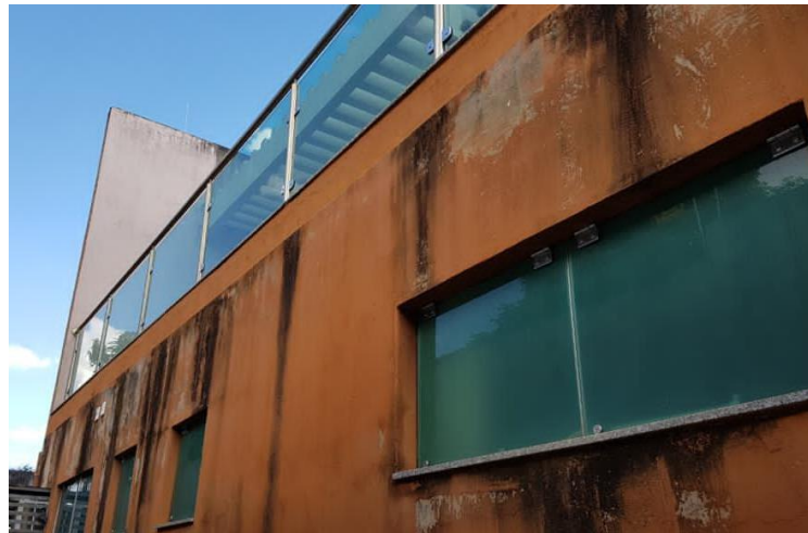
Figura 4 – Vista lateral da edificação retratando manifestações patológicas
