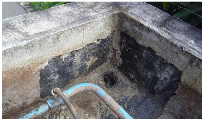
Figura 2 – Impermeabilização e sistema de drenagem ineficientes do telhado verde da garagem
