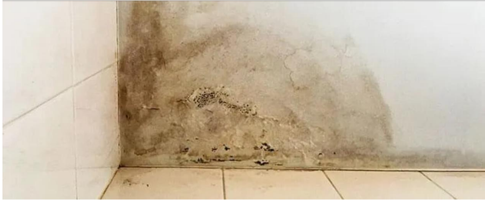
Figura 2.10 – Umidade ascendente provocando manchas escuras e degradação da pintura na parede
