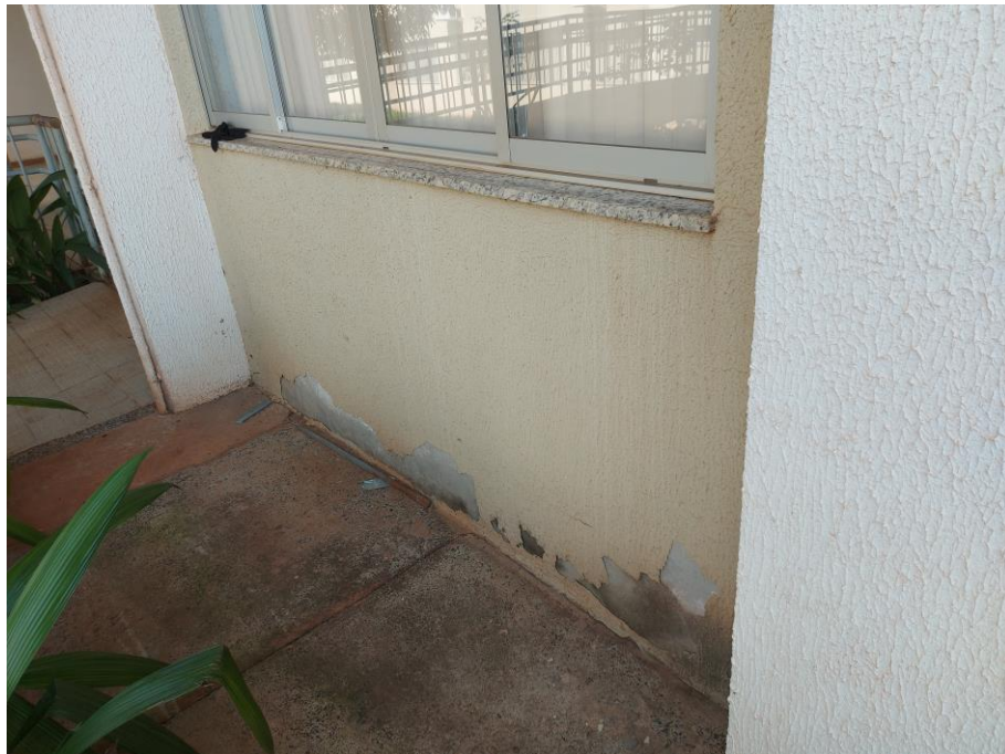
Figura 4.15 – Mancha de umidade em parede externa
