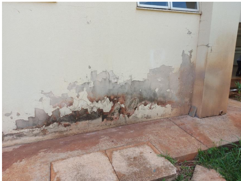
Figura 4.16 – Mancha de umidade por infiltração
