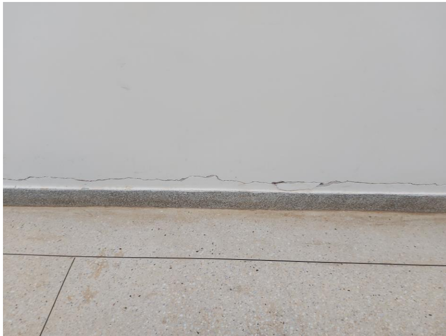
Figura 4.6 – Manifestação patológica com origem não relacionada ao revestimento
