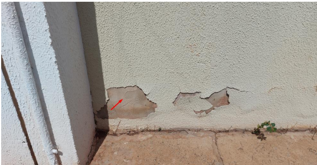
Figura 4.19 – Descolamento com empolamento.
