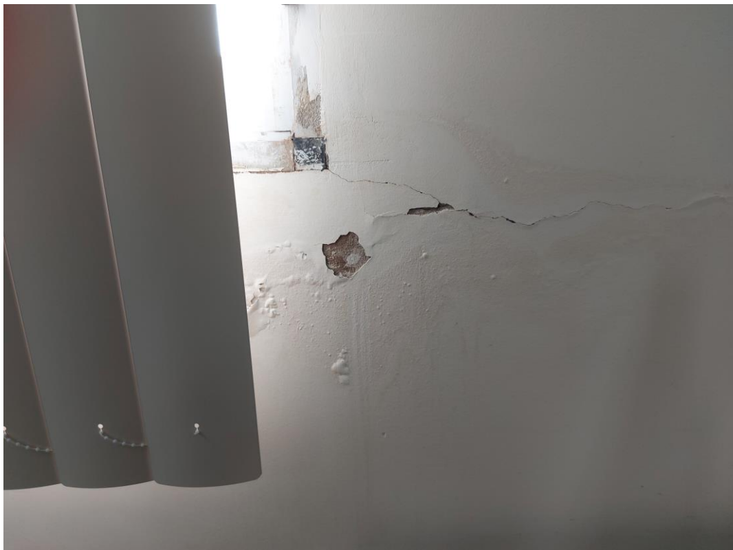
Figura 4.24 – Fissura na parte inferior de esquadria com mancha de umidade.
