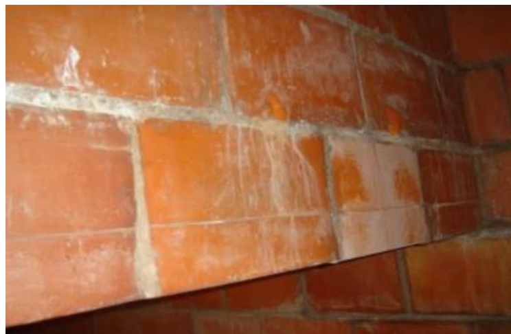
Figura 2.8 – Eflorescência tipo III
