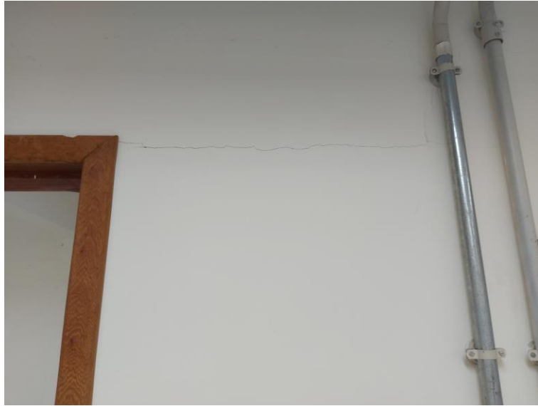
Figura 4.22 – Fissura horizontal em na parte superior de esquadria.
