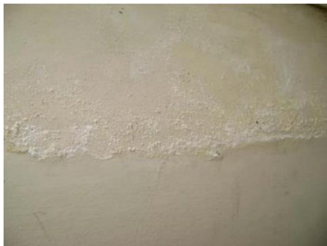
Figura 2.6 – Eflorescência tipo I
