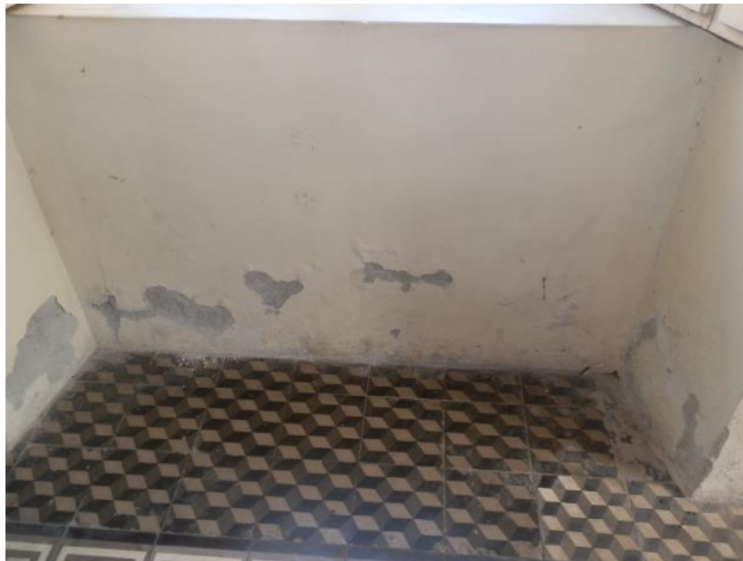
Figura 2.12 – Descolamento com empolamento presente na parede
