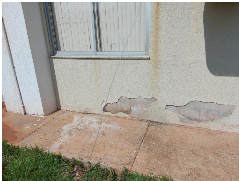
Figura 4.20 – Fissuras mapeadas em parede externa
