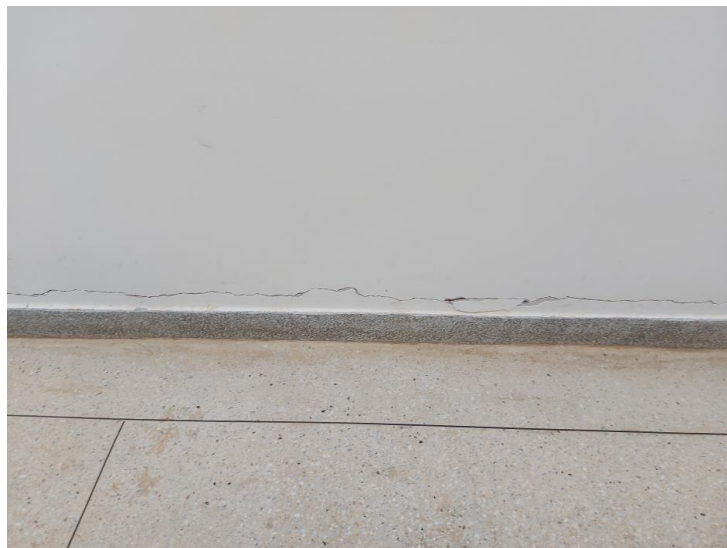
Figura 4.23 – Fissura horizontal acima do rodapé.
