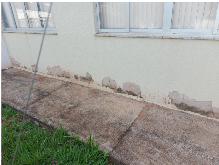
Figura 4.4 – Manifestação patológica em parede externa
