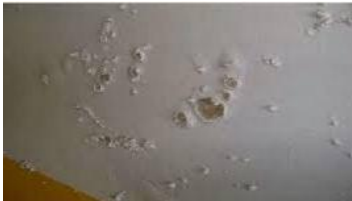
Figura 2.9 – Vesícula em revestimento de argamassa
