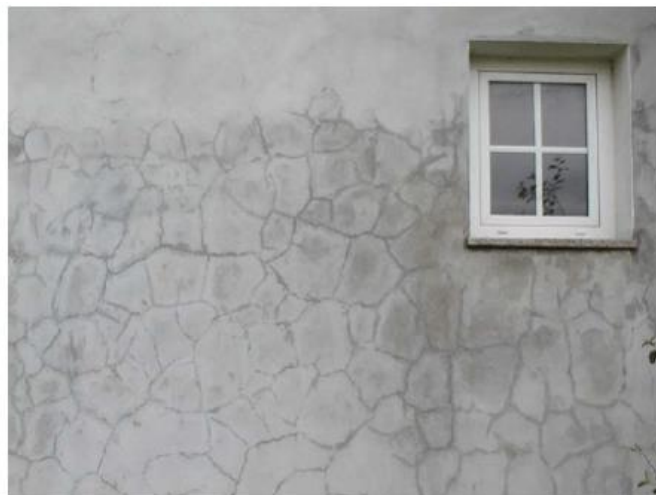
Figura 2.4 – Fissura mapeada causada por retração de secagem da argamassa
