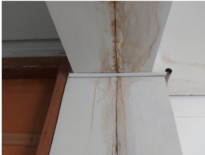
Figura 5.2 – Mancha de umidade causada da degradação das juntas de dilatação.
