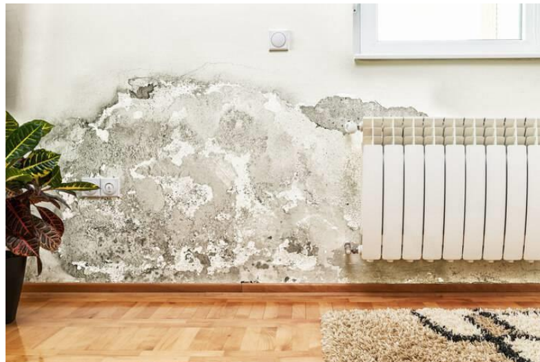
Figura 2.11 – Umidade ascendente provocando manchas escuras e degradação da pintura na parede
