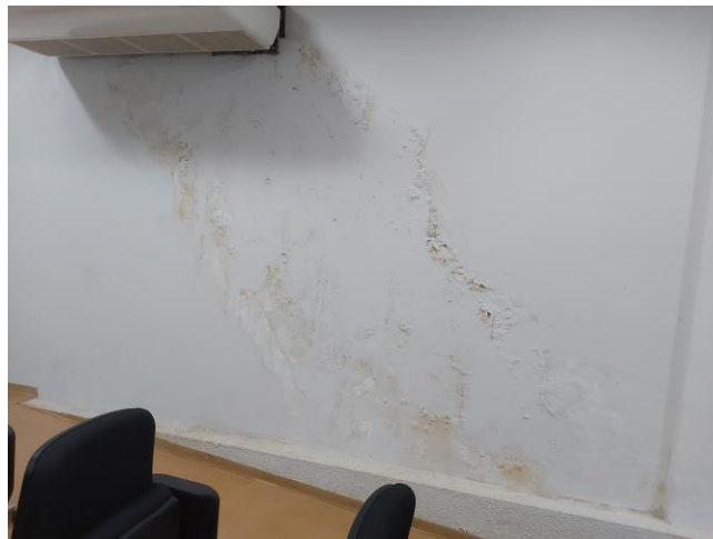
Figura 4.17 – Mancha de umidade na parede do miniauditório
