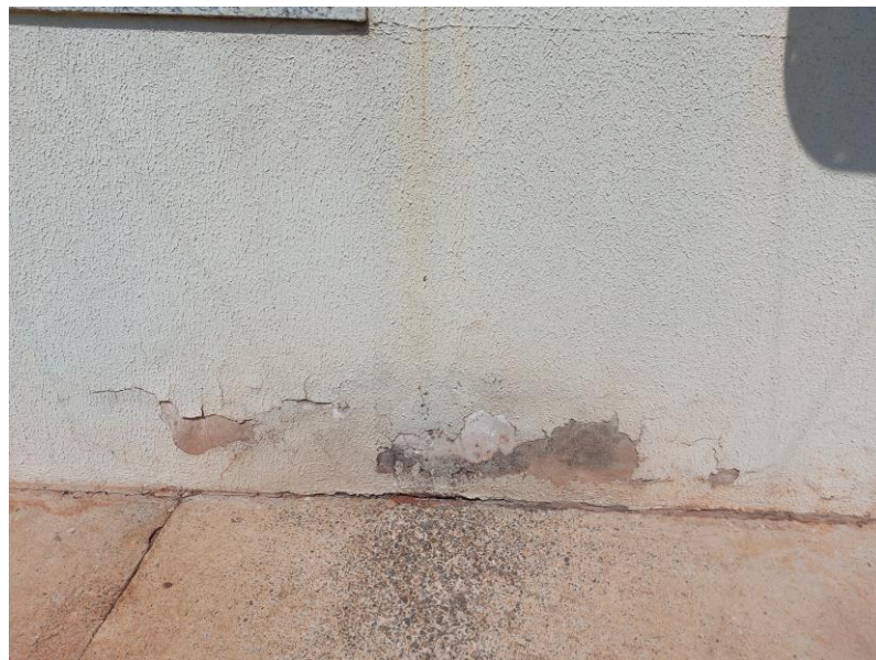
Figura 4.13 – Mancha de umidade por respingo
