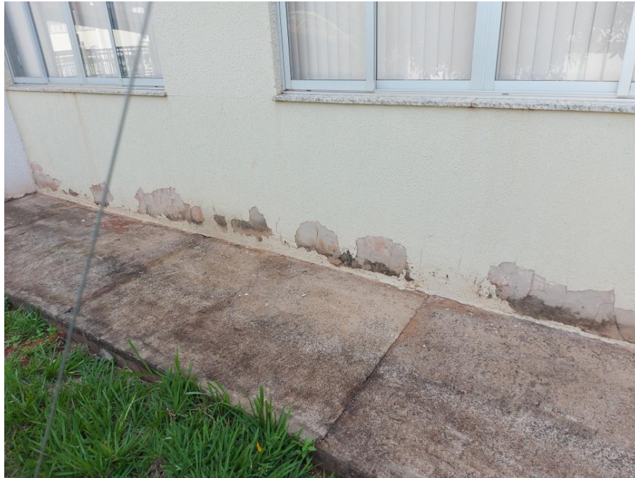
Figura 4.21 – Fissuras mapeadas e manchas de umidade
