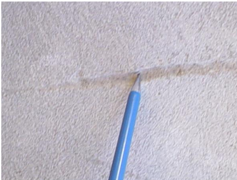
Figura 2.14 – Exemplo da baixa resistência superficial ao risco
