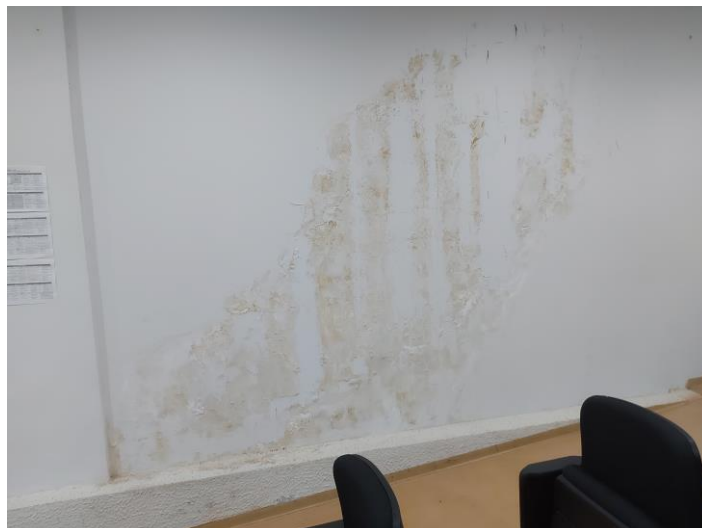
Figura 4.18 – Mancha de umidade na parede do miniauditório
