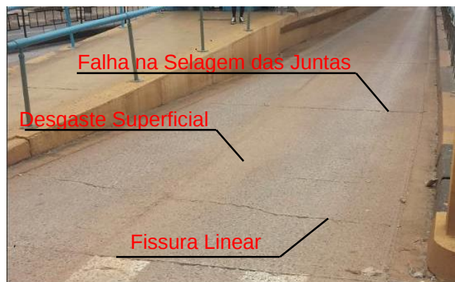
Figura 8: Estação Cascavel Pista Direita – Pavimento rígido do corpo - Patologias
