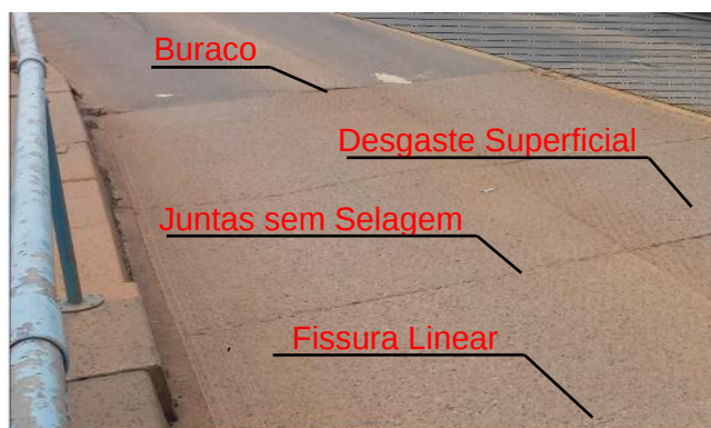
Figura 7: Estação Cascavel Pista Direita - Interface de Entrada - Patologias
