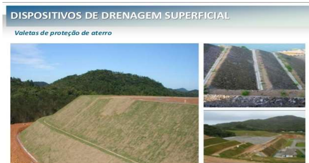
Figura 2: Dispositivos de drenagem superficial valetas de proteção de aterro
