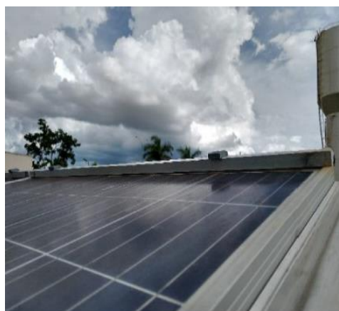
Figura 4.5: Perfis de alumínio para arrefecimento da string superior da planta piloto do Câmpus Aparecida de Goiânia do IFG. Fonte: MENDES, 2021.
