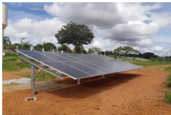
Figura 4.3: Vista lateral da planta piloto instalada em solo do Câmpus Aparecida de Goiânia do IFG. Fonte: MENDES, 2021.
