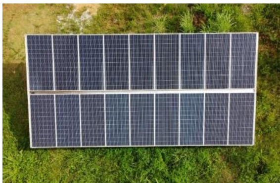
Figura 4.2: Vista aérea dos painéis da planta piloto instalada em solo do Câmpus Aparecida de Goiânia do IFG. Fonte: MENDES, 2021.
